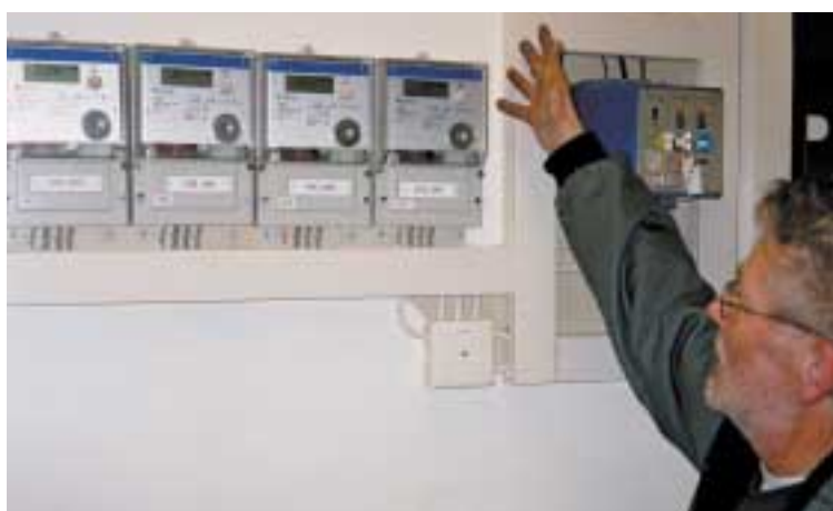
Fastighetsskötaren Börje Lövberg gör dagliga avläsningar av gångtid för värmepumparna respektive tillskottsel.
