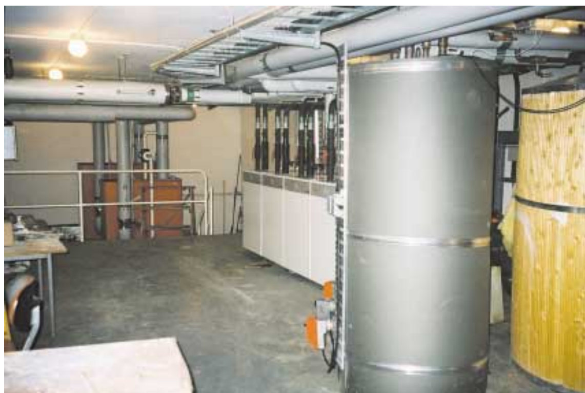
Värmecentralen med fyra Thermia Robust på vardera 45 kW ger naturlig värme för Vidarklinikens patienter och personal. Längst bort oljepannorna för stödvärme och längst fram varmvattenberedarna.
