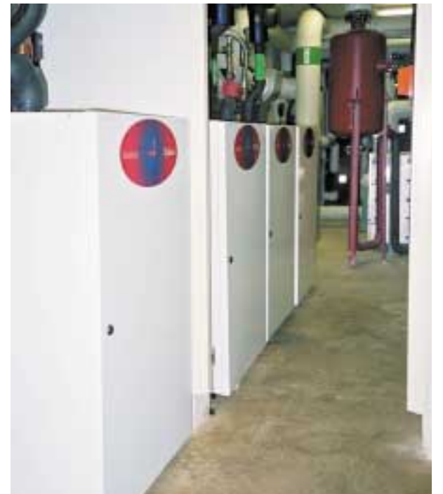
Fyra 45 kW värmepumpar från Thermia ger Brf Rostugnens 161 lägenheter bra värmekomfort.
