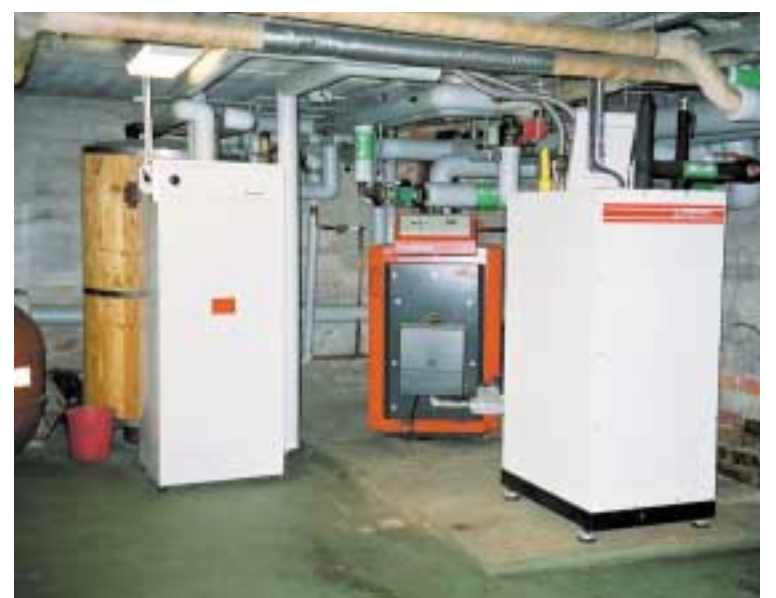
Det har blivit gott om plats i pannrummet sedan den gamla pannan och oljetanken togs bort.
