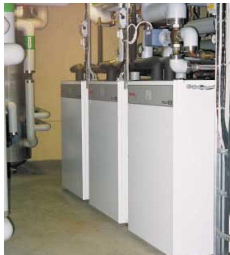
Thermias återförsäljare Triaden Värme AB har installerat tre 38 kW Robust värmepumpar i Hagaströmsskolan.
