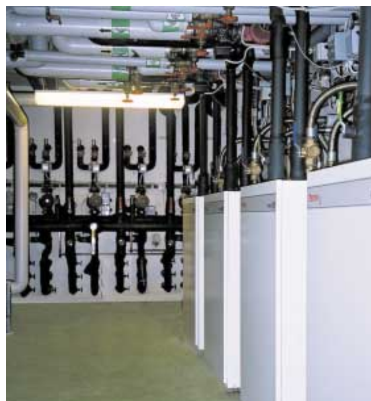
Bra jobbat grabbar, säger "Vän av ordning" när han ser värmecentralen på Alfta Rehab Center. De oisolerade, böjda flexslangarna på värmepumpstopparna är hetgasanslutningarna för slutvärmningen av varmvattnet och på väggen längst bak i bilden ses anslutningarna till markkolektorerna.
