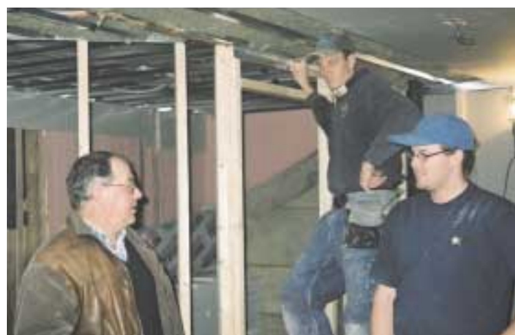
Thermias återförsäljare Rune Karlsson i samspråk med Patrik Thuresson som slutför renoveringsarbetet i kv. Rådhuset 22.
